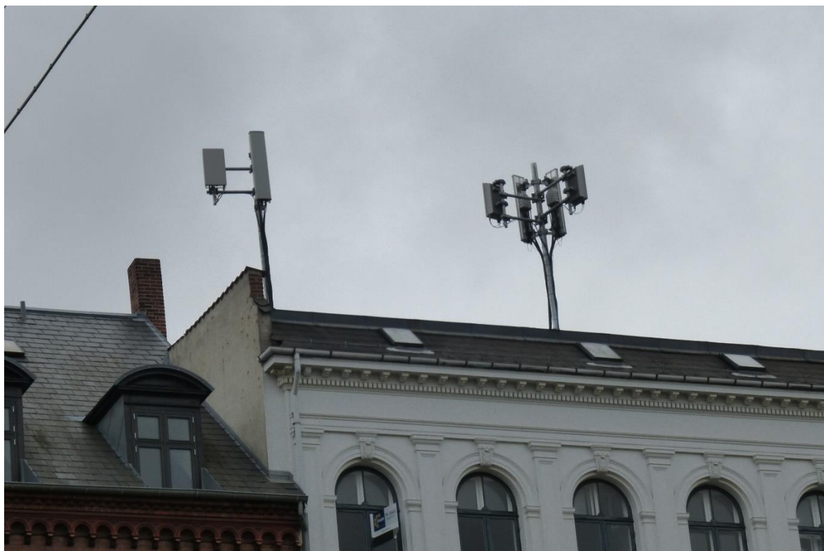
Antenner placeret på taget
